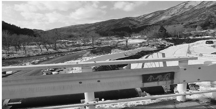
写真1 小本川と清水川の合流地点あたりにおける河川改修工事の様子 (橋梁は架け替え予定) (筆者撮影・2023年2月)
